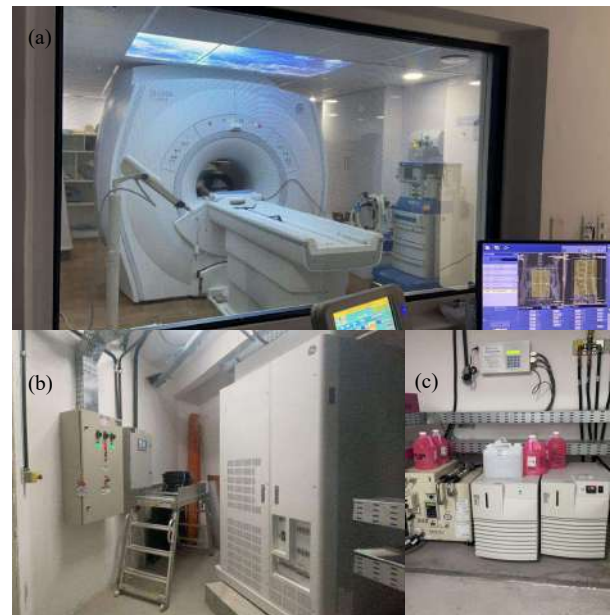
Fig. 1 Instalação concluída: (a) sala de exames e de comando, e (b) e (c) sala técnica.
